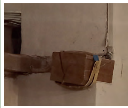
Der desolote gesprungene „tragende“ Balken
